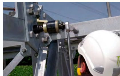
鉄塔での使用。トルクレンチによる正確な締め付けが可能
